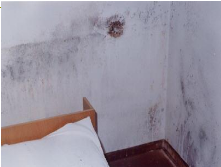
Schimmel sicher vermeiden
