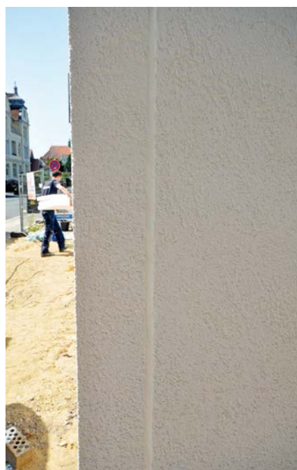
Geschlossene Dehnungsfuge in Putzoberfläche
