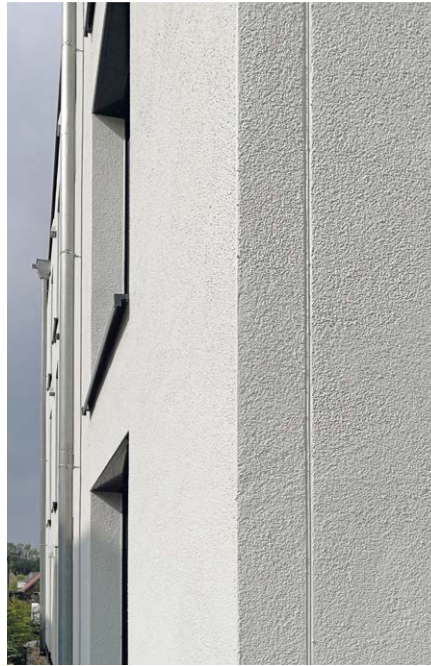
Geschlossene Dehnungsfuge in Putzoberfläche
